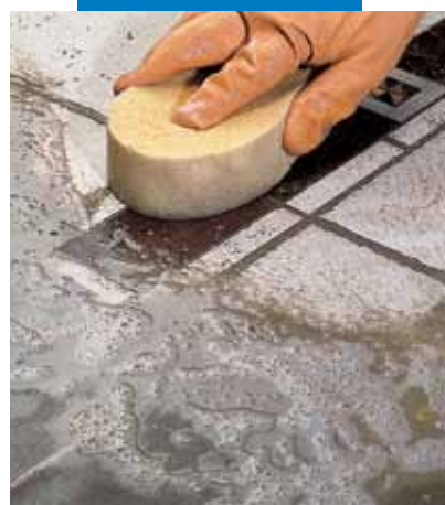
Példa fugázott akkumulátorhelyiségre
